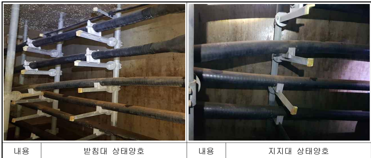
【사진 1.12】 부속 및 부대설비 현황
