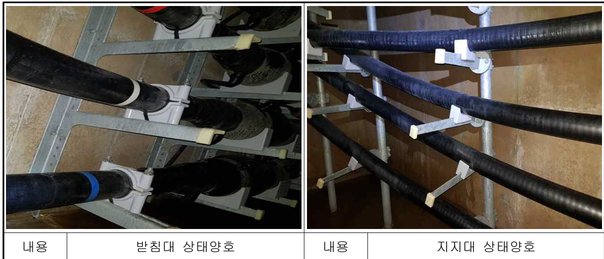
【사진 1.8】 부속 및 부대설비 현황
