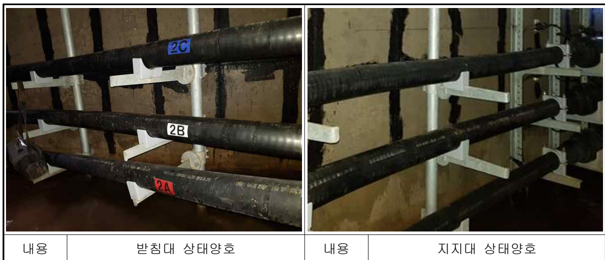
【사진 1.16】 부속 및 부대설비 현황
